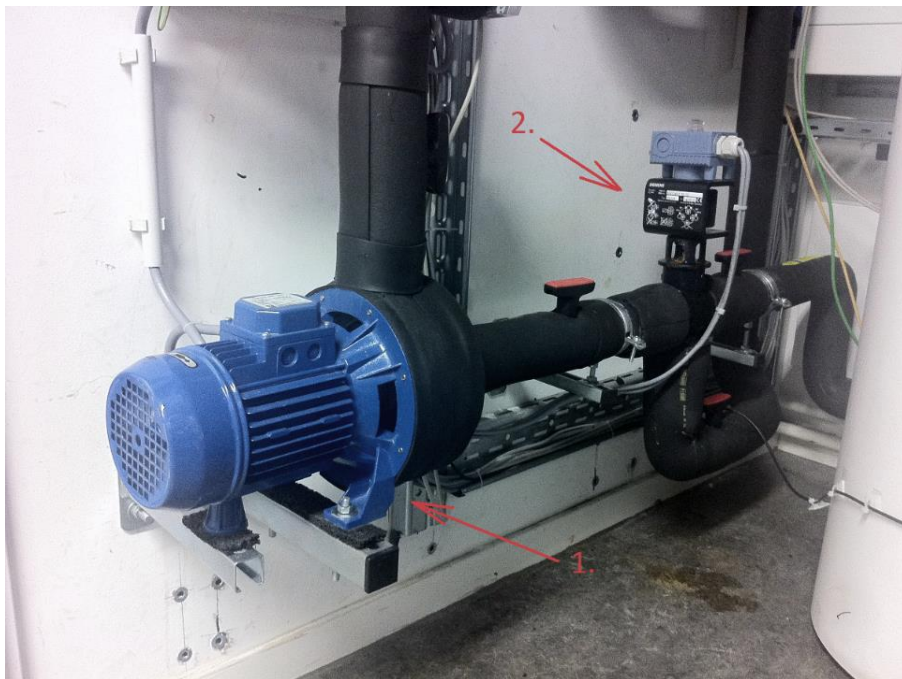
Abb. 7: Modernisierung der Komponenten (1.-Pumpe; 2.-Ventil)
